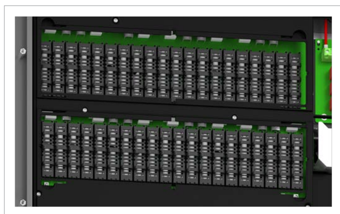
Abb. 4.15: Ansicht der DC-Stringsicherungen bei entfernten Abdeckungen
